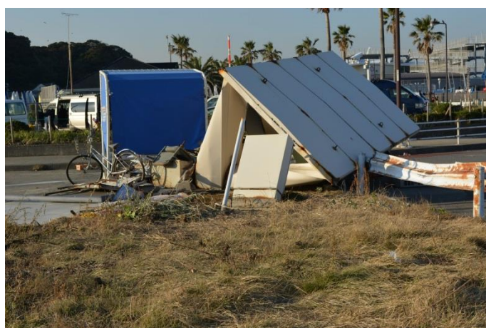
図-7 管理棟の建物が大破している様子
