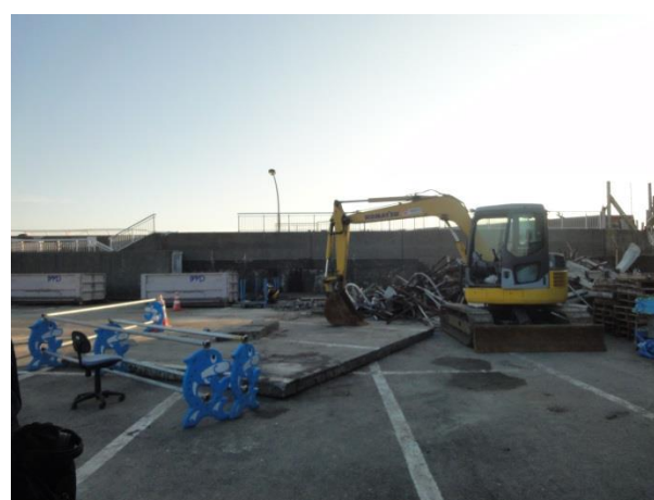
図-8 駐車場のコンクリート塊
