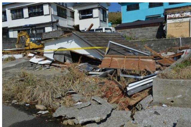
図-5 城ヶ島での被害の様子
