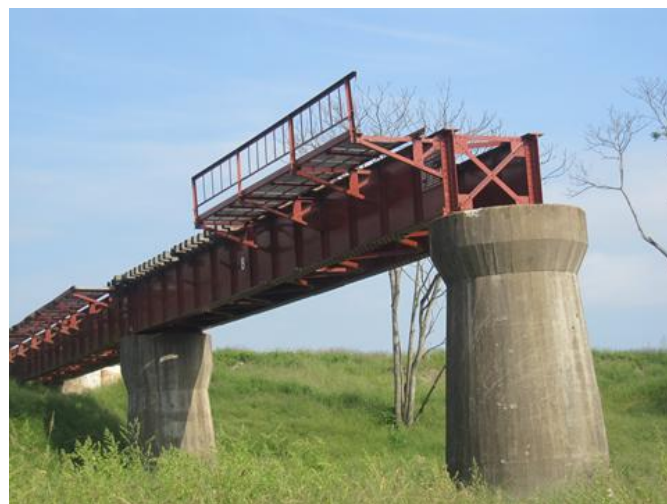
図7 倒壊しなかった橋脚
