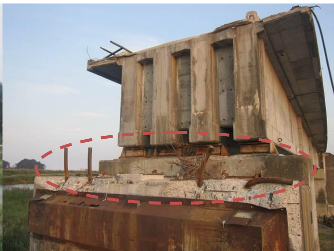
図3 支承固定用ボルトの変形
