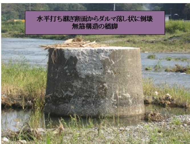
図9 橋脚の倒壊断面
