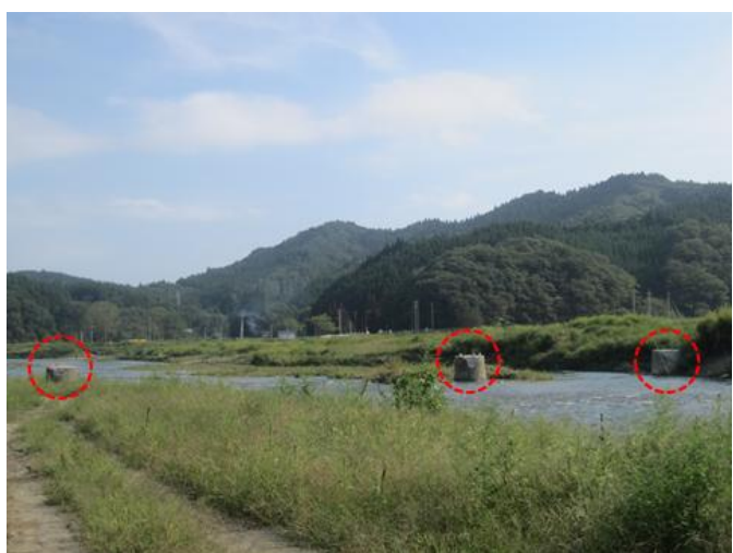
図8 倒壊した橋脚
