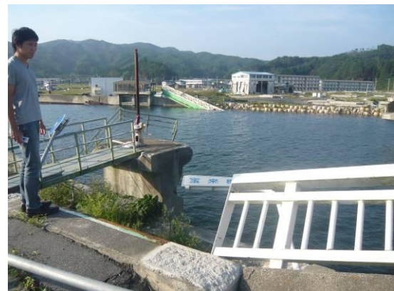
図 4. 橋梁が流出し、供用の目処が立っていない事例
