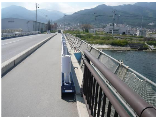
図 3. 高欄の流失のみで供用が再開されている事例
