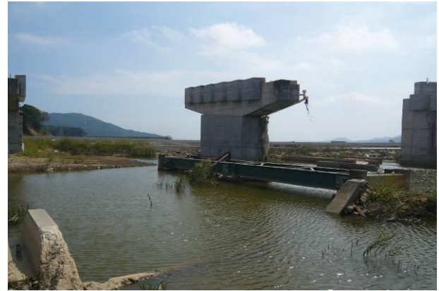
図8. 流失を免れた沼田避溢橋梁（鉄道橋）
