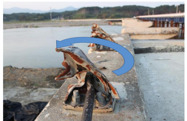
図2. 被害のあった橋梁の桁との接合部
