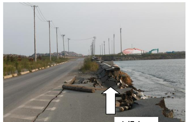
図1. 上揚力による道路被害状況
