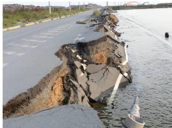
図 9 陥没し使用不能となった道路
