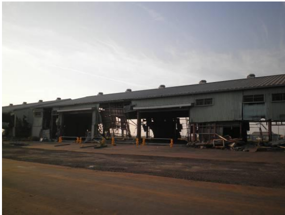
図 8 津波により破壊された港湾近くの建屋
