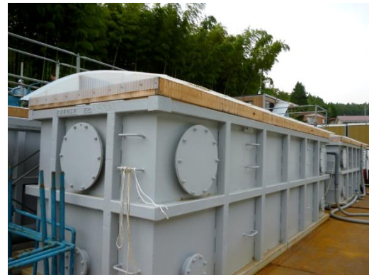
図 2 仮設の膜処理ユニット (陸前高田浄化センター)
