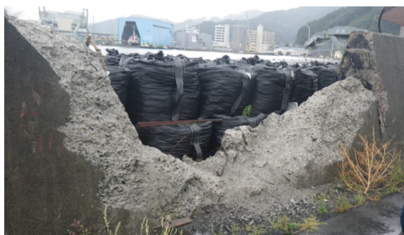
写真1 堤防の破損した箇所に積まれた土嚢
