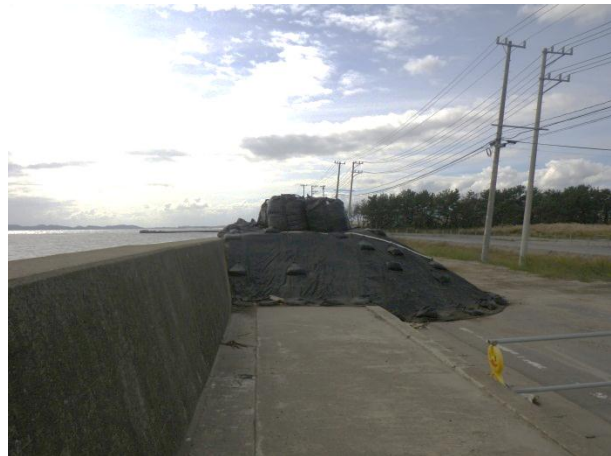
写真12 防潮堤の破損した箇所に設置された盛土
