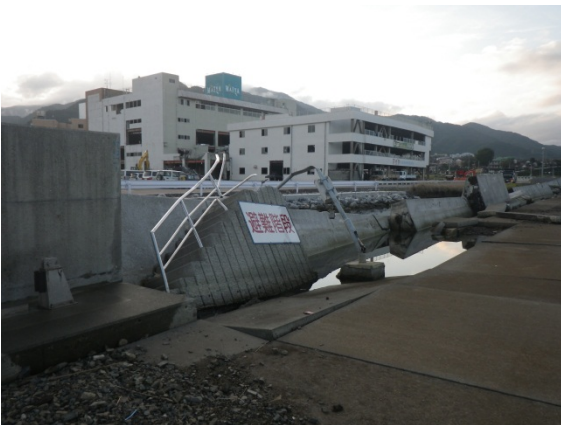
写真4 破損した防潮堤
