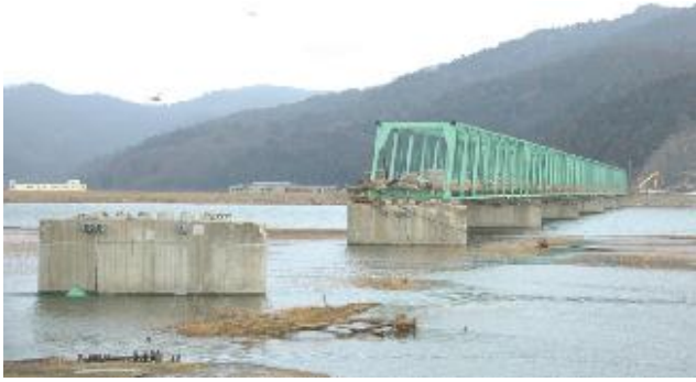
写真-4 被災直後の新北上大橋
