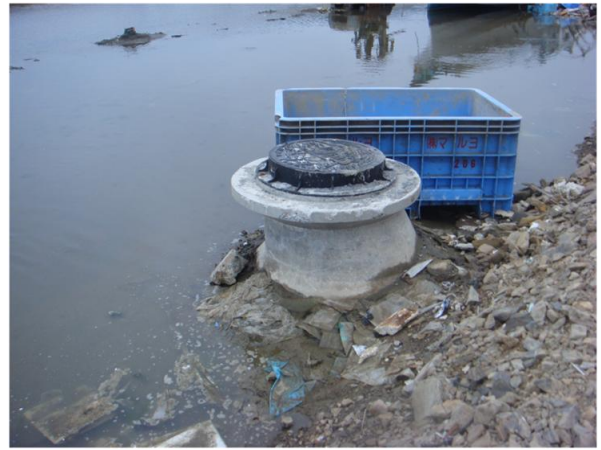
図3 浮き上がるマンホール(石巻市)
