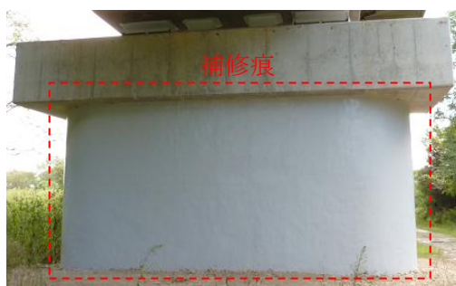
図4 金ヶ崎町寄り橋脚（損傷あり）
