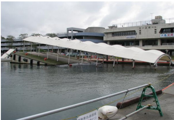
写真-3 気仙沼港フェリー乗り場の被害状況
