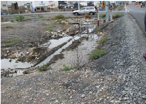
写真-1 周辺の地盤沈下
