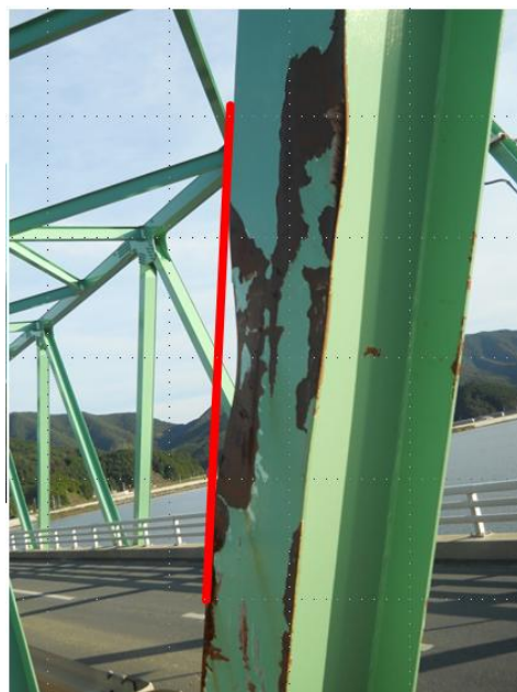
写真3 斜材の変形の様子
