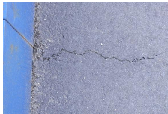
写真2 舗装のひび割れの様子
