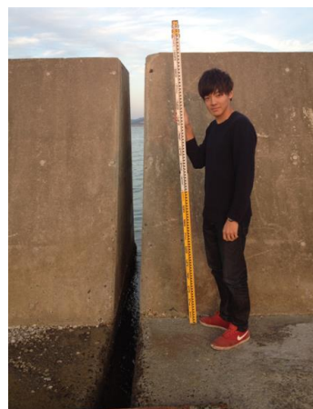
図-19 旧防潮堤滑動
