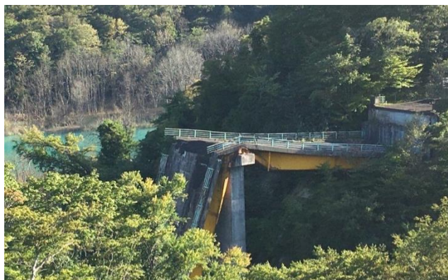
写真－4 崩落した祭時大橋
