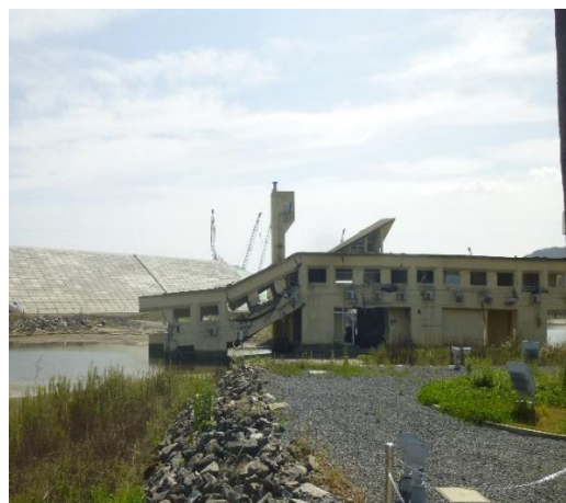
図 2. 地盤沈下及び液状化の様子
